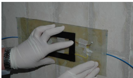
Rinforzo e monitoraggio real time di una struttura in muratura con smart patch
